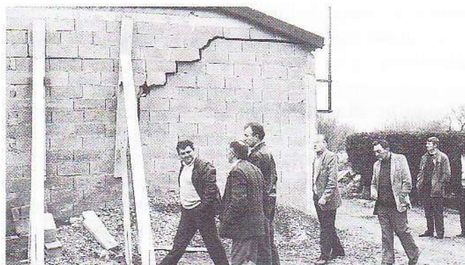
L'ancien hangar communal ne cachait plus ses fissures.
