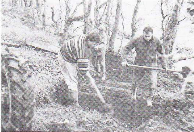
Les ouvriers de l'entreprise "Paysages d'Iroise" au travail sur le sentier littoral.
